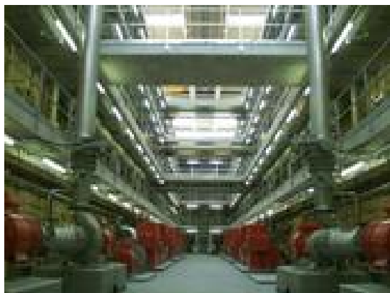
Seewasserwerk von Innen
